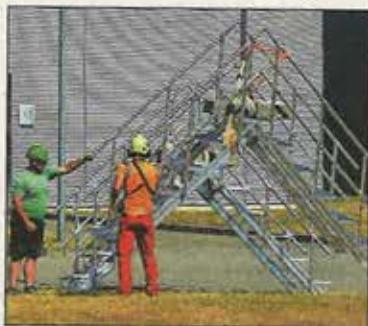
Am Boden: Andreas Zick (links) und Timo Schardon sind für die Befestigung der Treppen am Seil des Helikopters zuständig. FOTO: LOEFFEL
